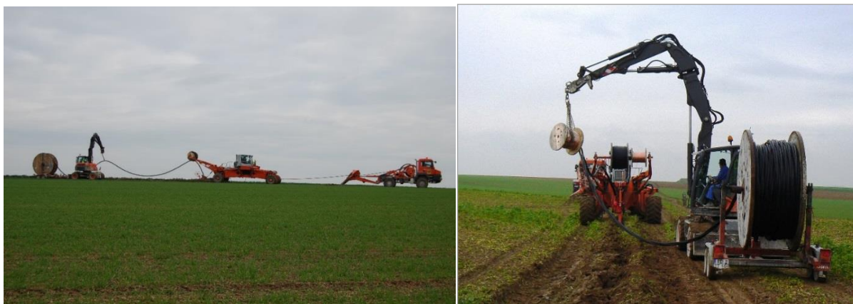
Photo d'un déroulage de câble HTA par la technique du soc tracté
