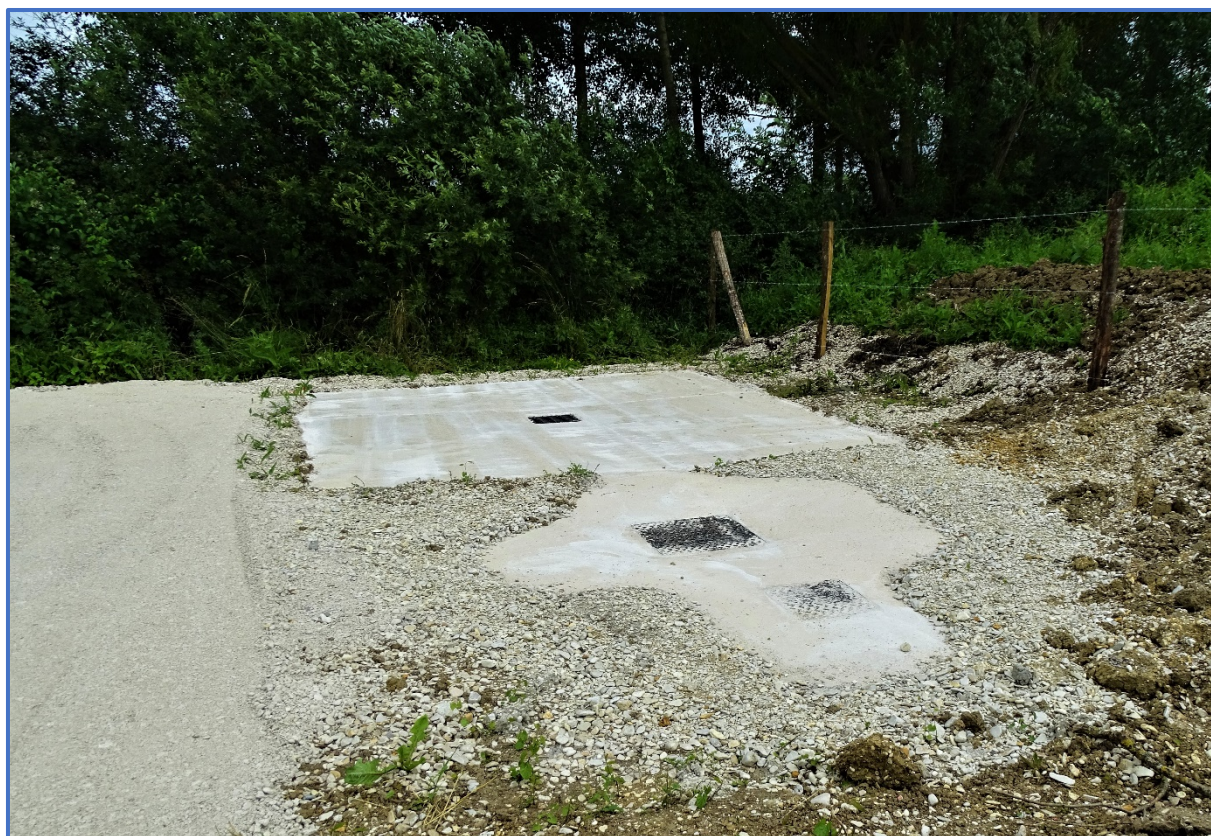
Exemple de l'aire étanche avec déshuileur (carrière autorisée à Sogny-en-l'Angle)
